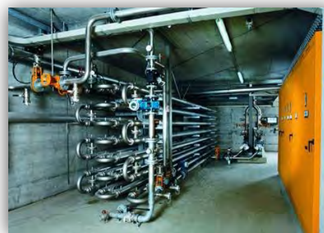
Figure 7: Echangeur tubulaire en sortie de STEP (Lyonnaise des Eaux, ISTINOX, ANTEA)
